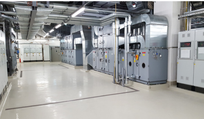
Bild: Fraport In den Tiefengeschoßen des Terminal 1 befindet sich die weitläufige LZ 43.
