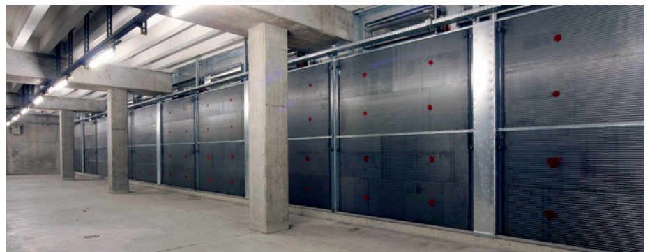
Neue Wärmeübertragerwand von Konvekta in der Zuluftzentrale zur Grunderwärmung der Aussenluft auf konstant 16 °C. (Bild: Kulle & Hofstetter)
