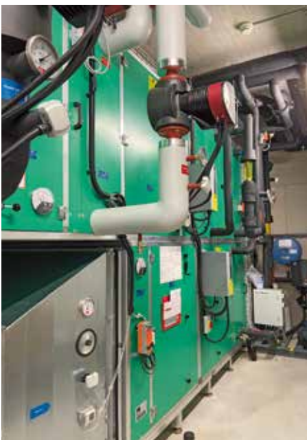
Lüftungsgeräte in der Technikzentrale und mit der Station der Energierückgewinnung von Konvekta.
