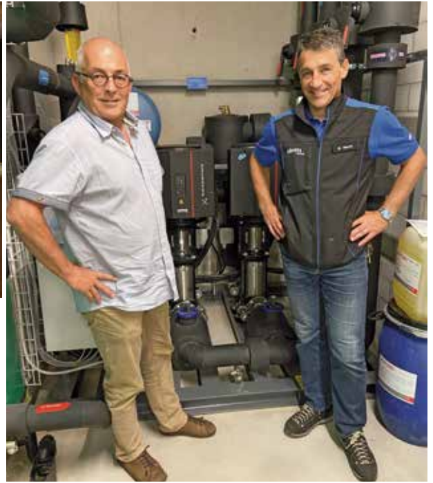
Roman Fuchs von Konvekta (links) und Michael Wehrli, Technischer Leiter der Säntis Schwebbahn (zu der auch das Hotel gehört), vor der Energierückgewinnung von Konvekta.
