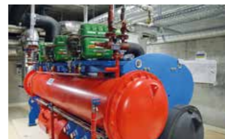
Das Herzstück der Kälteanlage besteht aus zwei baugleichen Engie Turbocor-Kältemaschinen, die mit dem Kältemittel R1234ze arbeiten.
